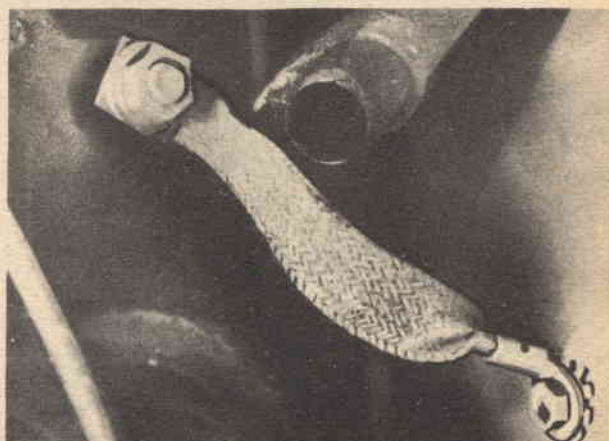
I collegamenti di massa dovranno essere eseguiti con treccia di rame, curando che i contatti siano efficienti.
